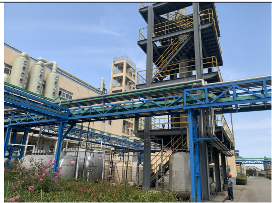
氨水回收装置
