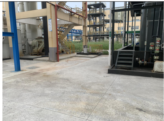
亚钠车间地下收集池
